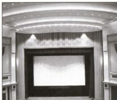
Entspricht höchsten Anforderungen an Erdbebensicherheit, Brand- und Schallschutz: Die Decken- und Wandkonstruktion aus KNAUF-Trockenbausystemen im Großkino Olympion I.
